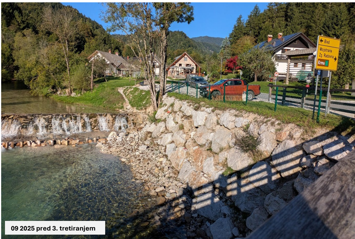
Slika 13. Pogled na žarišča češkega dresnika v skalni zložbi, gorvodno od mostu čez Radovno, pred prvim in tretjim tretiranjem z elektriko v letu 2025. Foto: arhiv Zavoda Symbiosis, junij in september 2025
